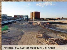
CENTRALE A GAZ, HASSI R' MEL - ALGERIA
