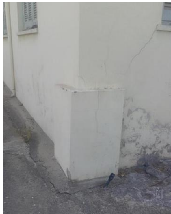
Φωτ. 2. Γωνιακό υποστύλωμα μονοόροφης μονοκατοικίας θεμελιωμένης επί Μάργας Λευκωσίας σε συνοικία της Λευκωσίας μετά από την επισκευή της βλάβης που του προκάλεσε η διόγκωση, η οποία συνεχίστηκε και μετά την επισκευή.
