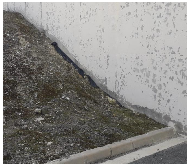
Φωτ. 2. Επίχωση που έχει υποστεί κατάρρευση λόγω διαβροχής δίπλα από τοίχο αντιστήριξης στην Κύπρο.
